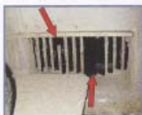
床下通風口の破損
