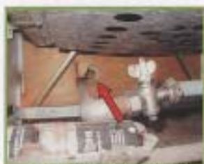
コンベック点検口内部より配管まわりに隙間が
