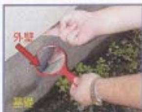
基礎と壁の間に隙間あり (鏡と指を使い点検)
