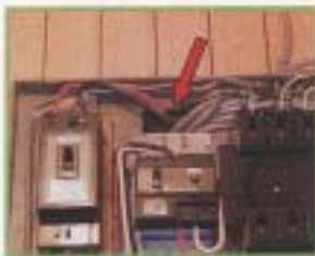
分電盤のカバーをはずすと壁の内部に通じる隙間が見えます
