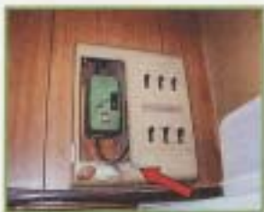
ブレーカー下部から出入していただくカバーが真っ黒
