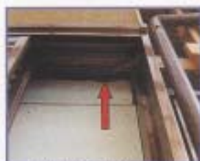
戸袋内部の石膏ボードが 削られていた例
