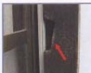
雨戸の戸袋から壁の内部へ 侵入することが多い
