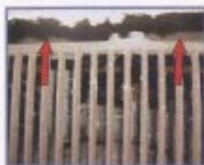
破損はないが上部に隙間がある (鏡を使い下から見る)
