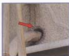
エアコン配管の壁貫通部分 (パテがはがれている)
